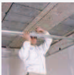
Po zamocowaniu profili UD na obwodzie pomieszczenia umieszczamy wieszaki i montujemy profile podłużne CD.
